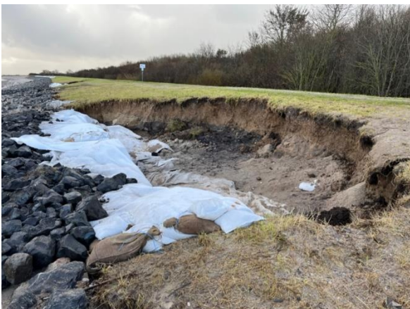
Abb.: Stark beschädigter aber provisorisch gesicherter Ostseedeich nach der Sturmflut im Oktober 2023 © M. Stanisak
